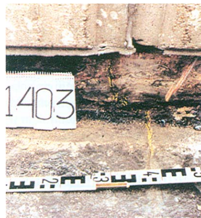
Slika 6. Pukotina u sljubnici za rastezanje, na spoju ruba
